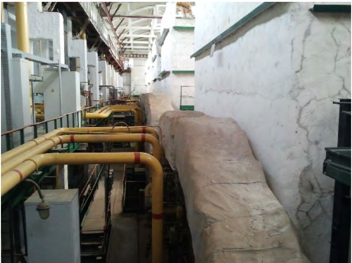
Рисунок 1 – Котлы КВГМ-100 на котельной «Южная» (г. Витебск)
